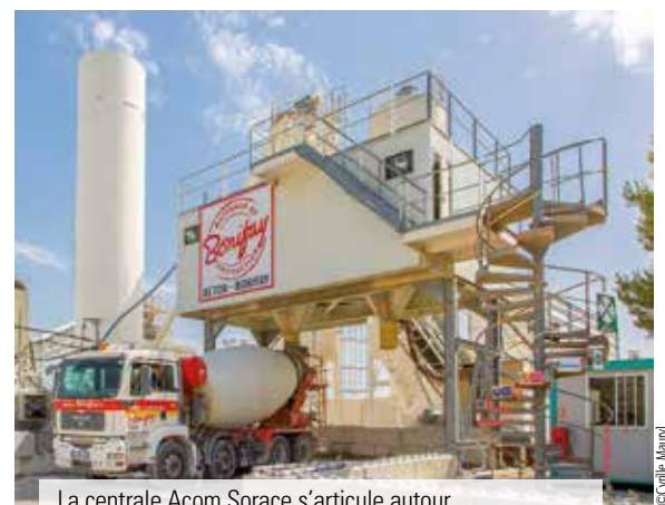
La centrale Acom Sorace s'articule autour d'un malaxeur de 2 m 3 Imer Oru 3000/2000.
